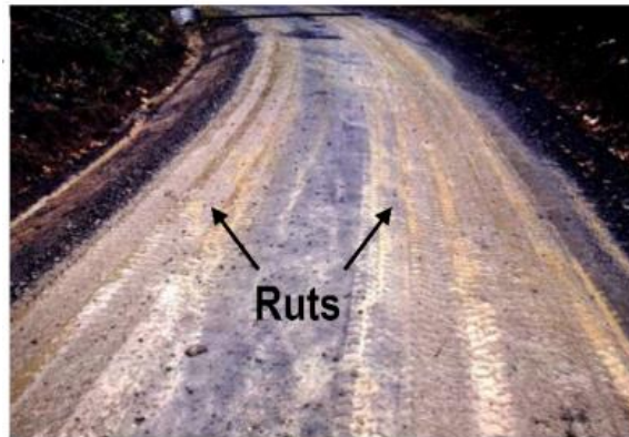
Figura 2. Efecto del mal sistema de drenaje en las carreteras sin pavimentar
